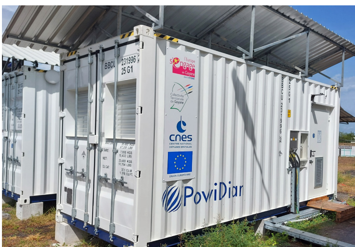
CNES (Guyane) : alimentation de secours
