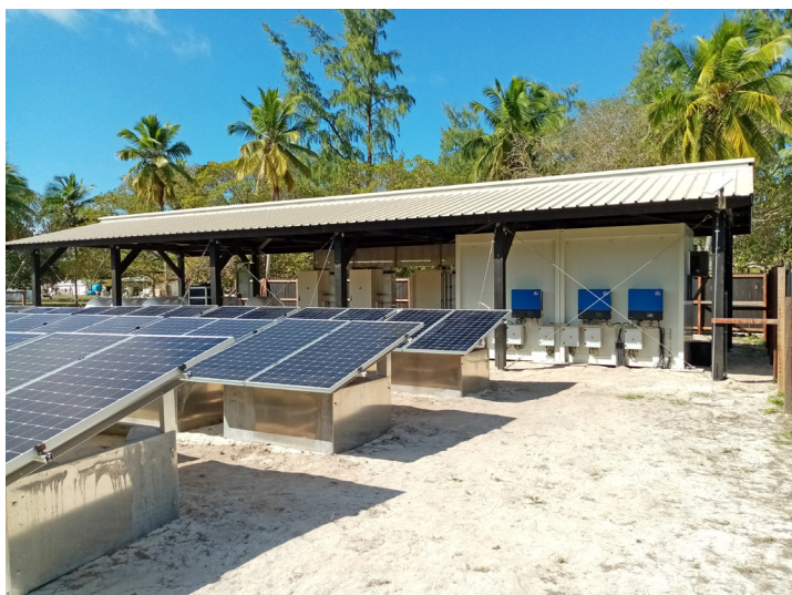
île Glorieuse (TAAF) : site non raccordé à un réseau électrique
