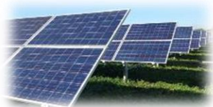
Centrale PV : 2,4 MWc
